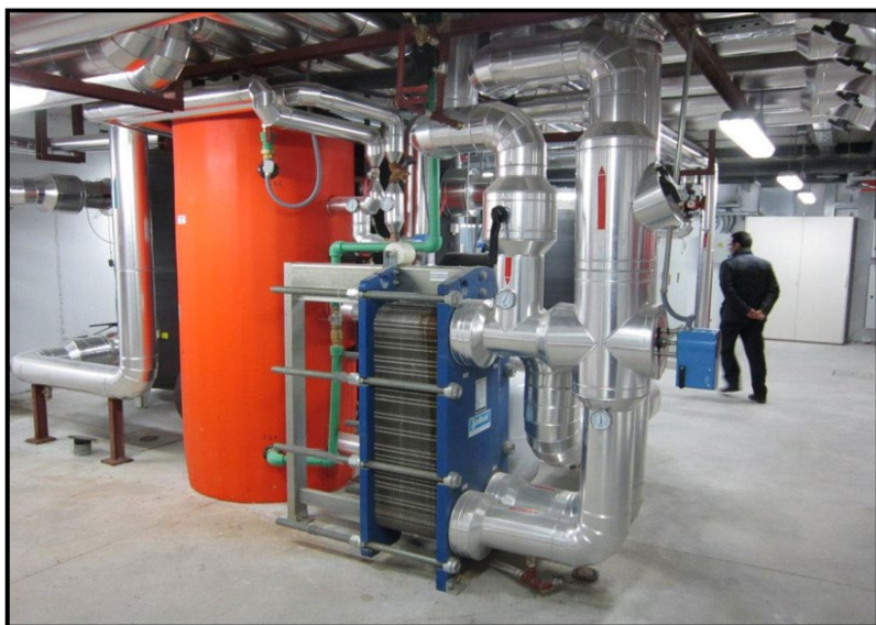
Imagen 6-5 Instalaciones del Edificio Polivalente
